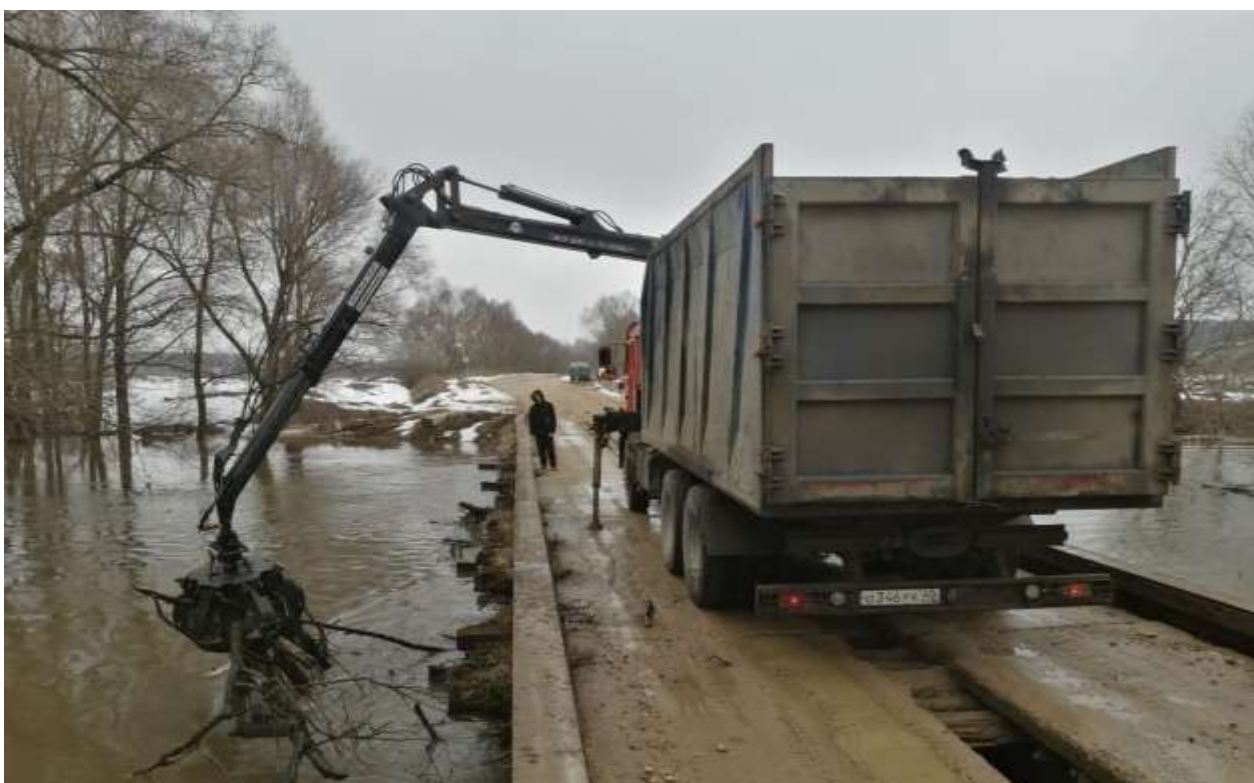
Очистка от мусора мостового сооружения через реку Лужа возле н.п. Игнатьевское Малоярославецкого района
