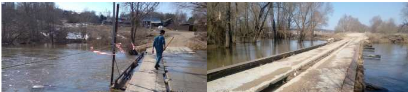
12.04.2021 – освобождение мостовых сооружений от воды в районе н.п. Игнатьевское Малоярославецкого района и Агрофенино Боровского района
